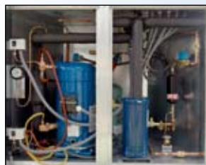
Fot. 3 - pompa ciepła
